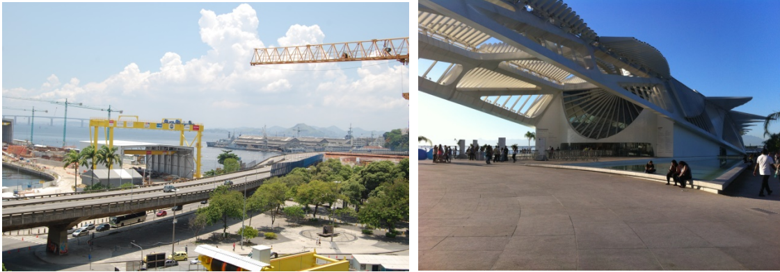
Fig 19: Praça Mauá antes da remoção da via elevada e o píer com o museu em obras, 2014; Museu do Amanhã, 2018 (Fotos: J. Bassani)
